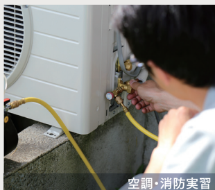
空調・消防実習
