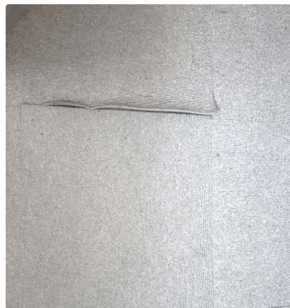
カーペットの剥がれ
