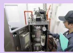
ボイラー設備 危険物取扱い
