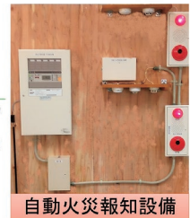
自動火災報知設備
