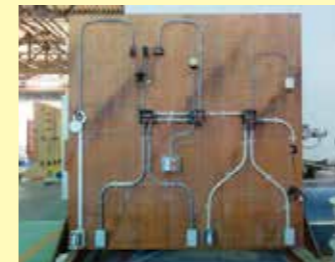
▲電気機器の配線
