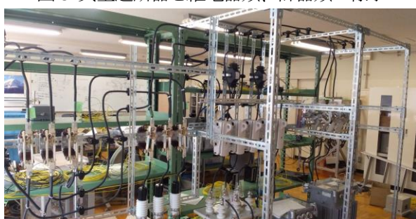
図4 開閉器類の様子
