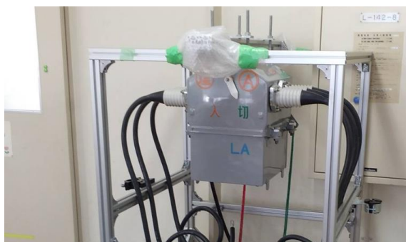
図2 柱上気中負荷開閉器の実習装置
