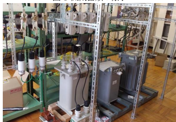
図5 変圧器類と進相コンデンサ類
