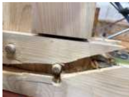
図 3 中柱柱脚破壊性状
