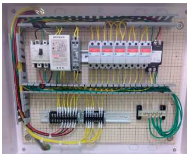
図 14 本実習機の配電盤(外観)
