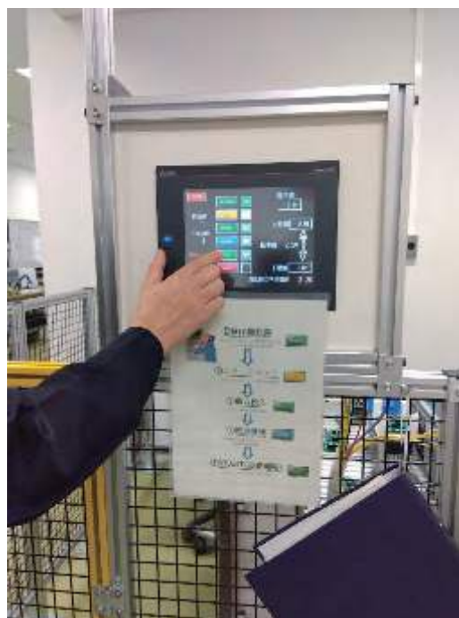
図 12 表示器の設置状況
