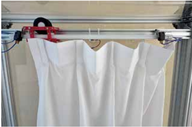
図5 自動開閉カーテン
