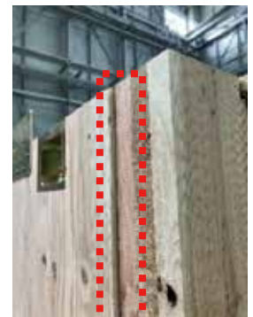
図 17 パネル角部のずれ
