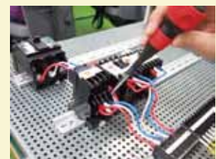
電磁接触器への配線
